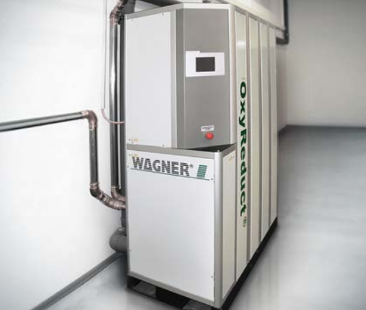
▲ Im NBG6 sorgt eine OxyReduct® Brandvermeidungsanlage für die notwendige Sauerstoffreduzierung
