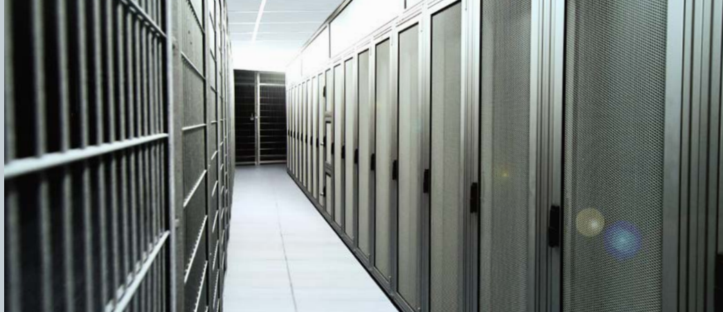
▲ Die noris network AG betreibt in Nürnberg eines der modernsten Rechenzentren Europas
